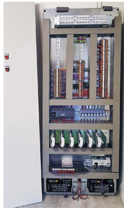
Die Zentraltürsteuerung «Altbau Kirchacker» mit Amoküberwachung und Backupkreislauf.
